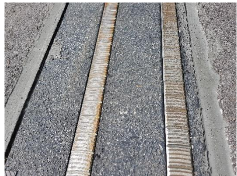
Figure 1 - APS Alimentation Par le Sol - Copyright ALSTOM
